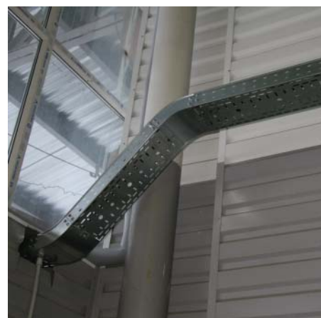
Изменение уровня кабельной трассы
