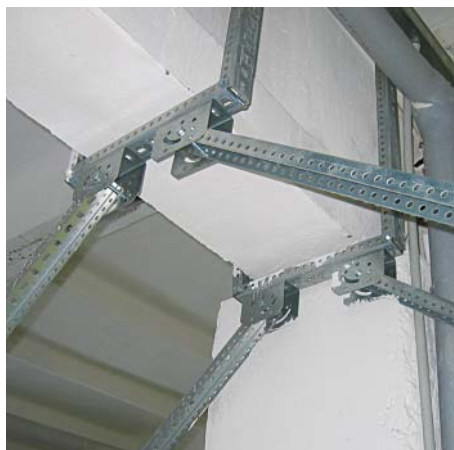
Монтаж узла подвеса к потолку при прокладке трассы с пролетом в 4..6 м
