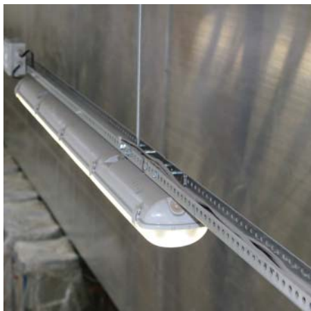
Подвес светильника на профиле и шпильке
