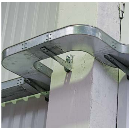
Использование 4-х углов СРО для обхода колонны при прокладке кабельной трассы по стене
